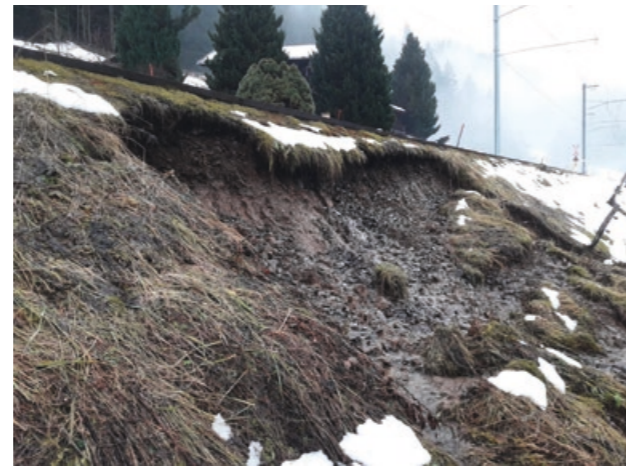
Ligne de l'ASD – Glissement de terrain aux Echenards
